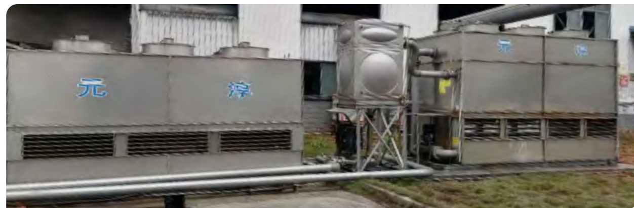
石墨化炉循环水冷却塔
